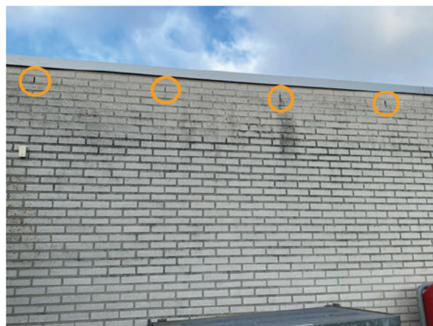
Afbeelding 12. Open stootvoegen in de muur aan de oostzijde
