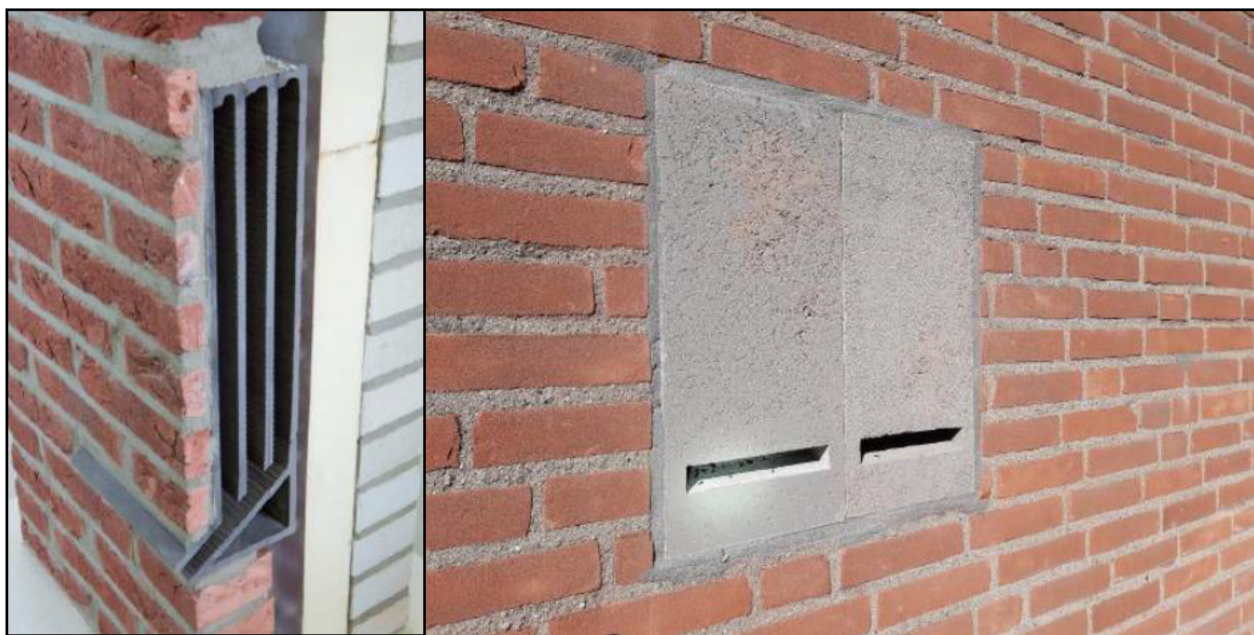
Figuur 2 Verschillende vormen van inbouwkasten met links een onzichtbare inbouwkast van Tichelaar en rechts een zichtbare dubbele inbouwkast van Unitura.
