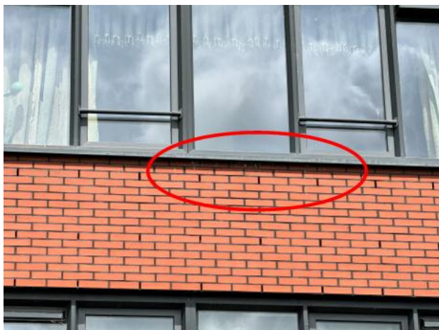
Laan der VOC 430 – nest- en rustplaats onder kozijndorpel
