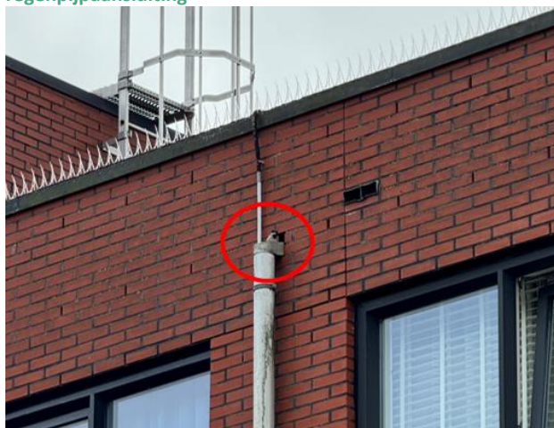
Laan der VOC 428 – 430 – nest- en rustplaats boven regenpijpaansluiting
