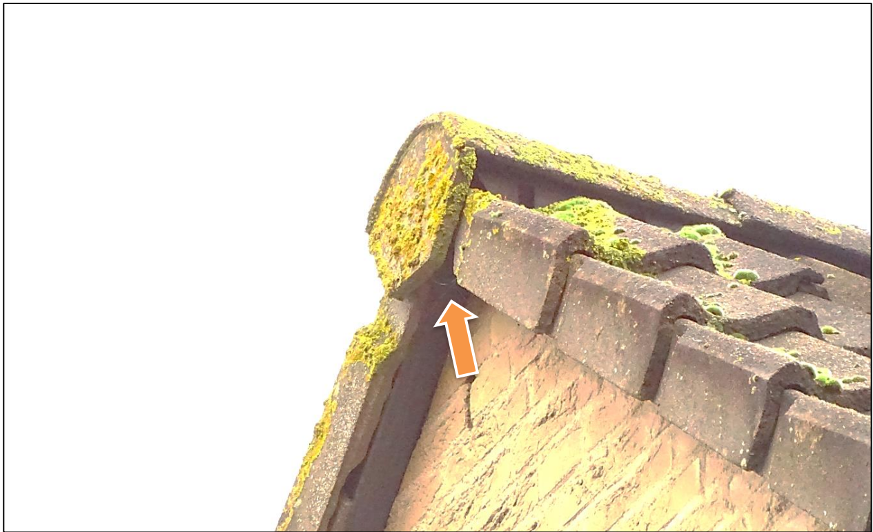
Figuur 4.3 Ruimte onder eindvorst, geschikt om in te vliegen voor gierzwaluw. Bij kantpannen is onvoldoende ruimte.
