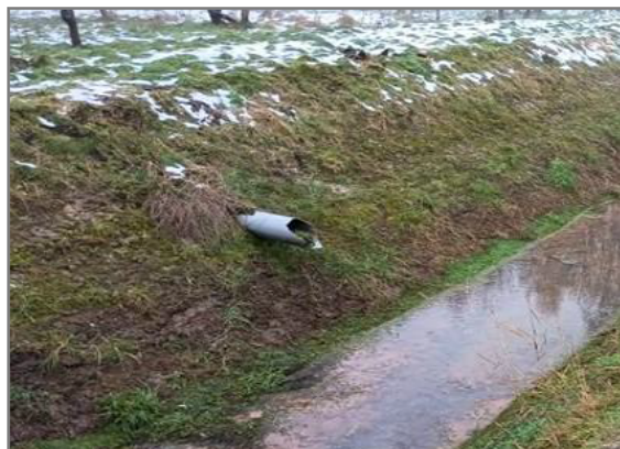
Afbeelding 3 | Pijpen in oever dienen niet te worden beschadigd.
