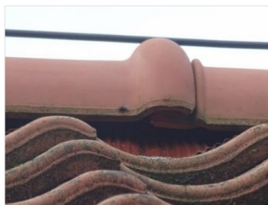
Figuur 5.1 Geen openingen onder de nokpannen .
